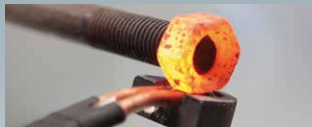
Releasing of rusted bolts Dégrippage de boulons rouillés Lösen festsitzender Muttern/Bolzen
